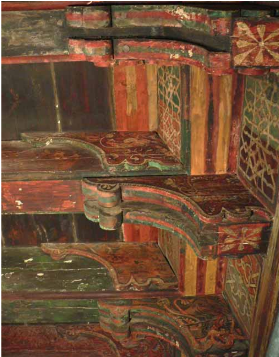
Figure 6.8 : Rive sud, vue en contre-plongée : deux niveaux de supports superposés. (Cl. A. Marin, 2004)
