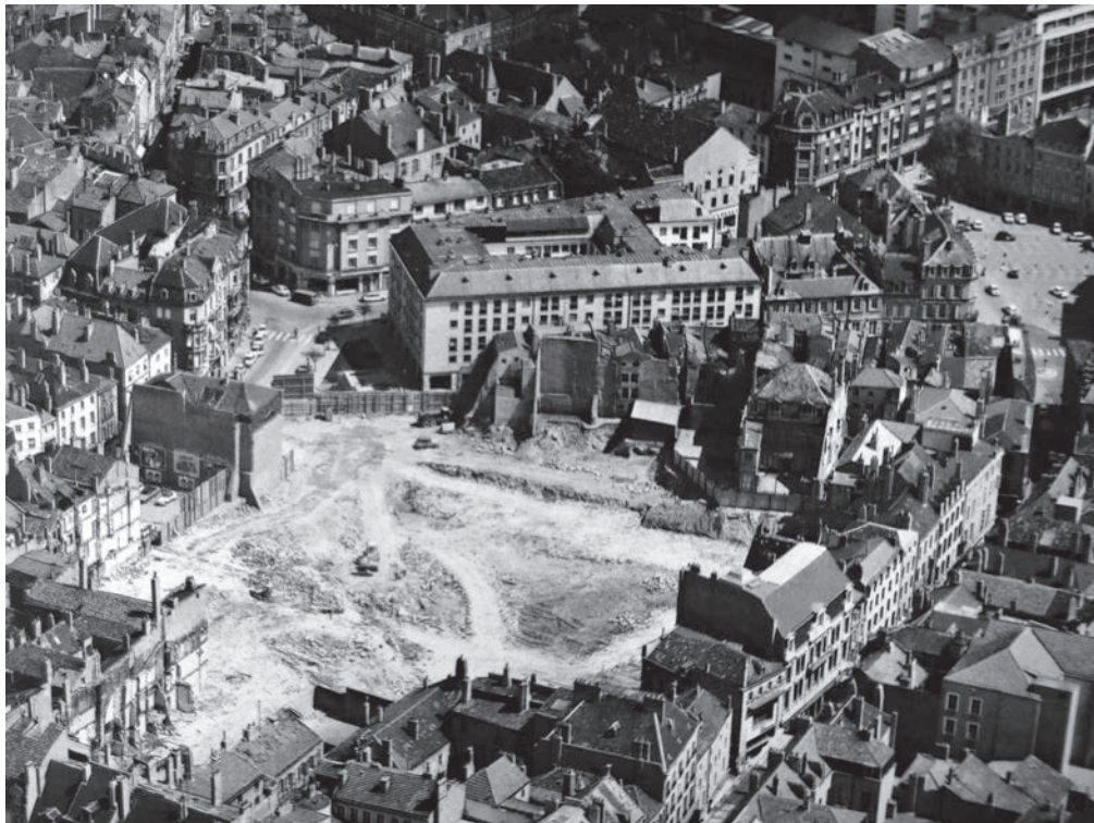
III.31. Metz, démolition de l'îlot Saint-Jacques - îlot du Change réhabilité, 1974. Photographie aérienne de Louis Schmidt extraite de BUCCIARELLI (M.), 2010, p.44-45.
