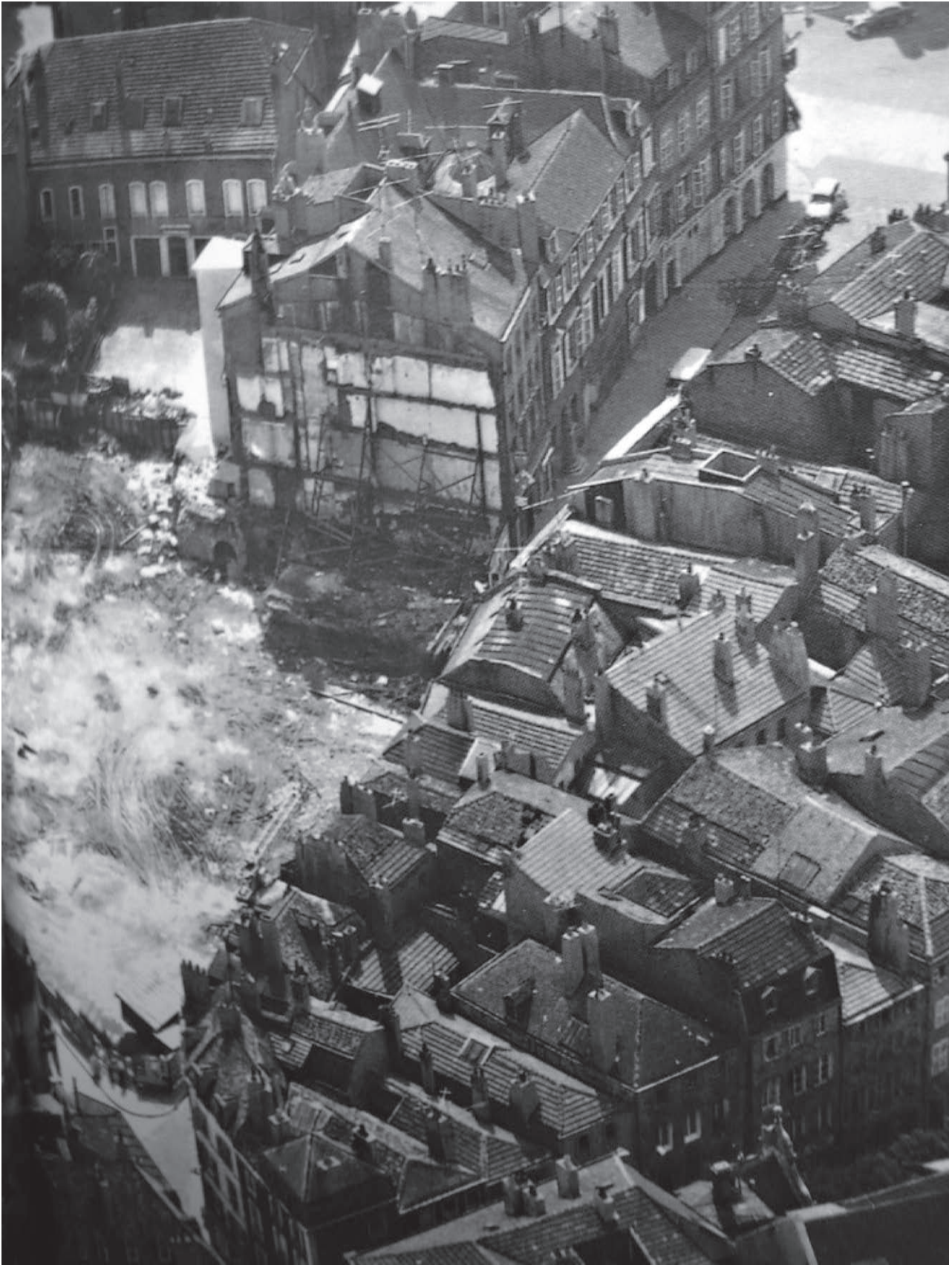
III.29. Metz, démolition de l'îlot du Change, 1968. Photographie aérienne de Louis Schmidt extraite de BUCCIARELLI (M.), 2010, p.38-39.
