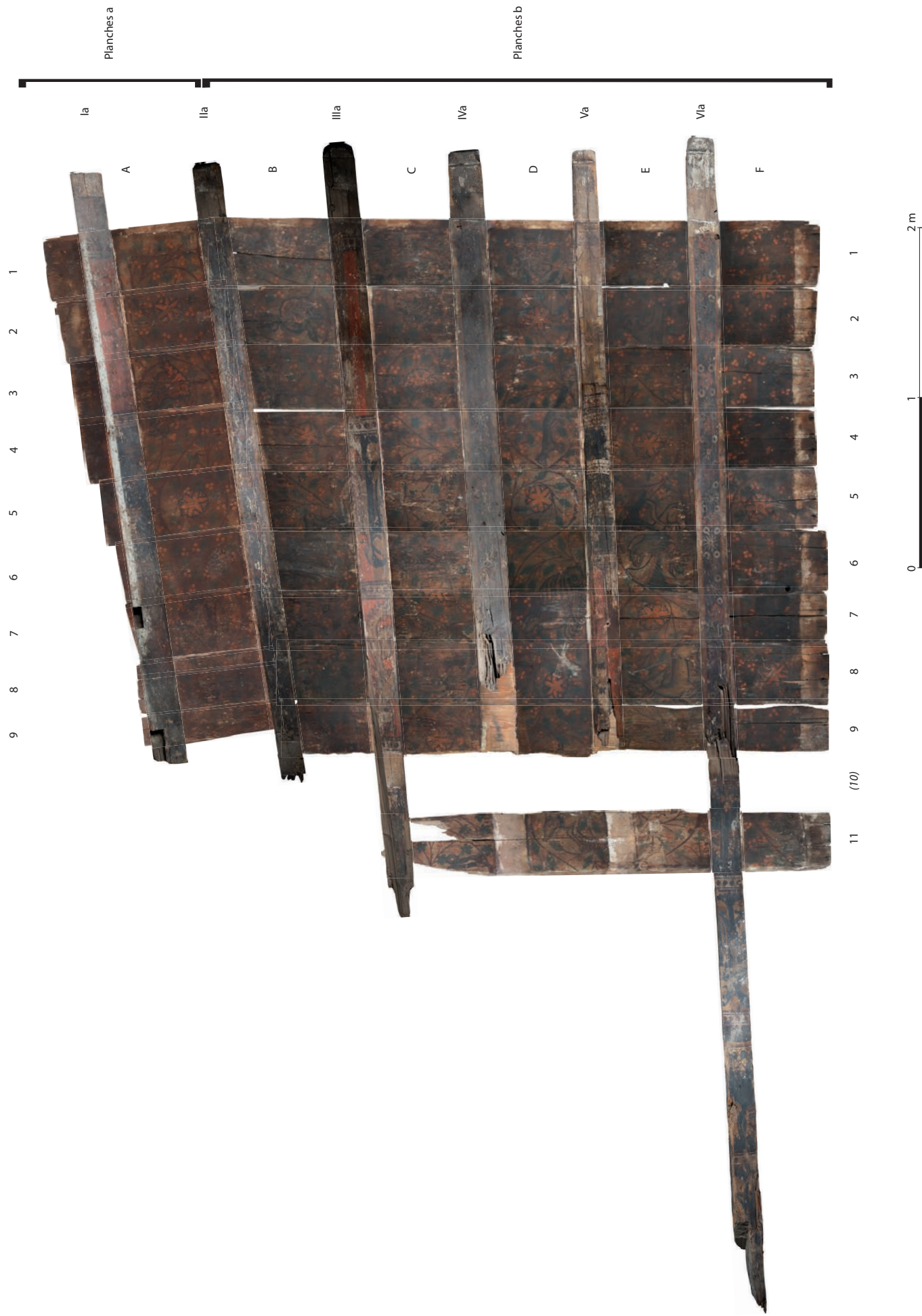
III.85. Reconstitution numérique du plafond peint du n°12-14 rue du Change à Metz (2010.0.380). Photographies : M.C.O.-L.K ; Infographie: J.T et N.P.,2011.
