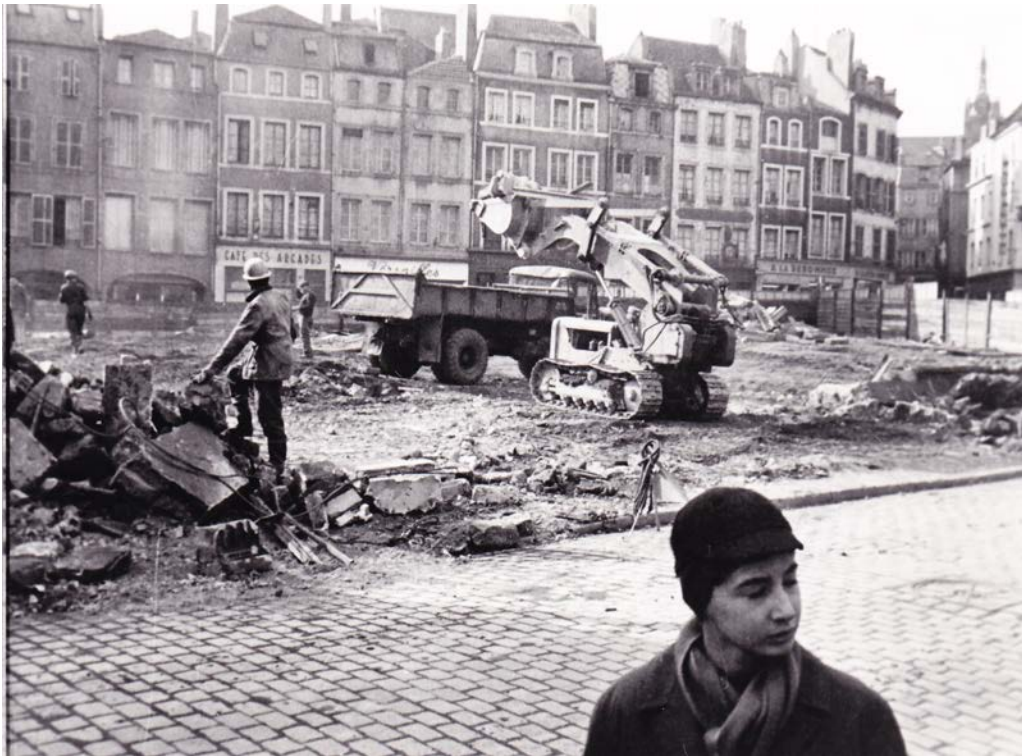
III.22. Metz, entre la rue Haute-Seille et la rue du Change, mars 1964. Photographie: A.M.M. 2fi586.
