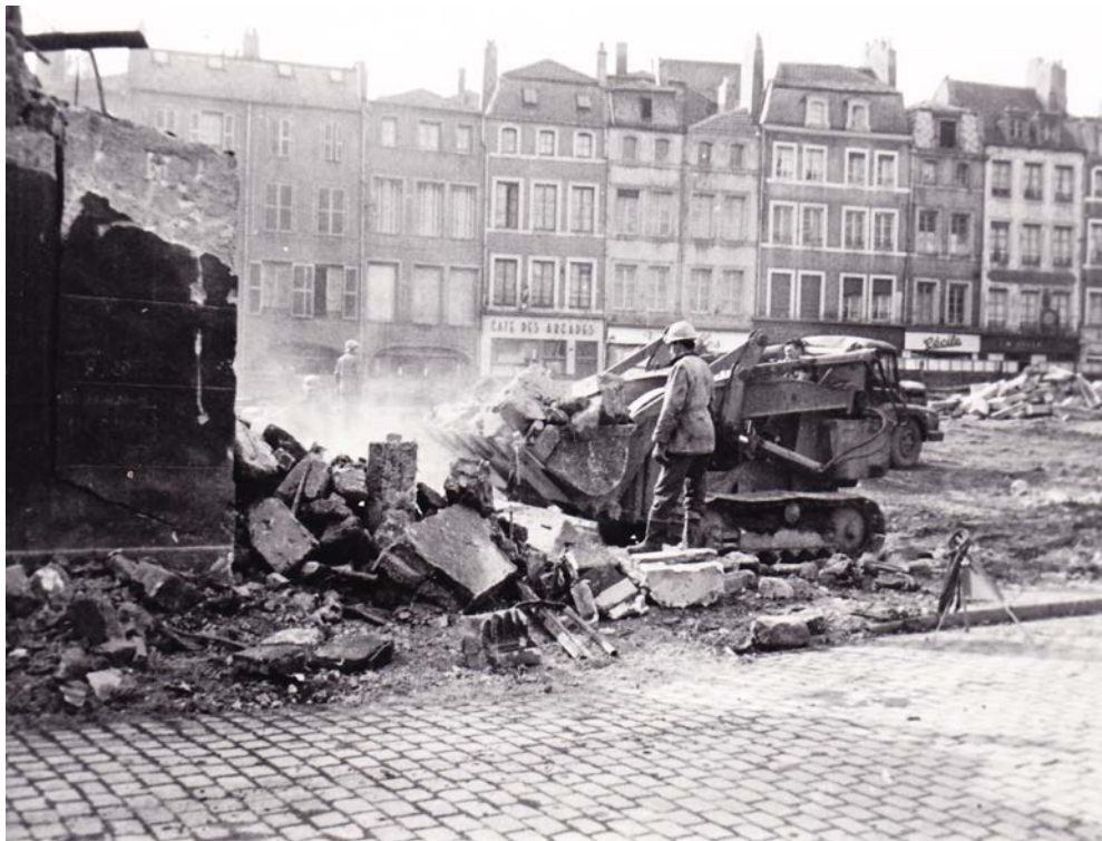
III.19. Metz, démolition de la rue Haute-Seille- îlot du Change, mars 1964. Photographie: A.M.M. 2fi584.
